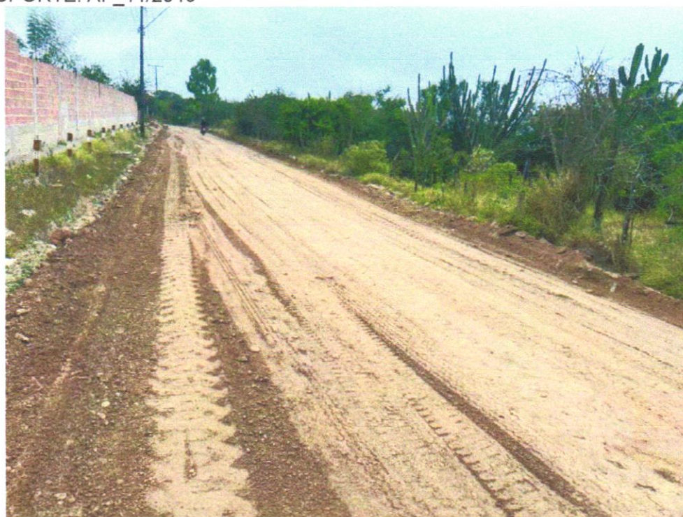
FOTO 04 - EXECUÇÃO E COMPACTAÇÃO DE ATERRO COM SOLO PREDOMINANTEMENTE ARGILOSO - EXCLUSIVE SOLO, ESCAVAÇÃO, CARGA E TRANSPORTE. AF_11/2019
