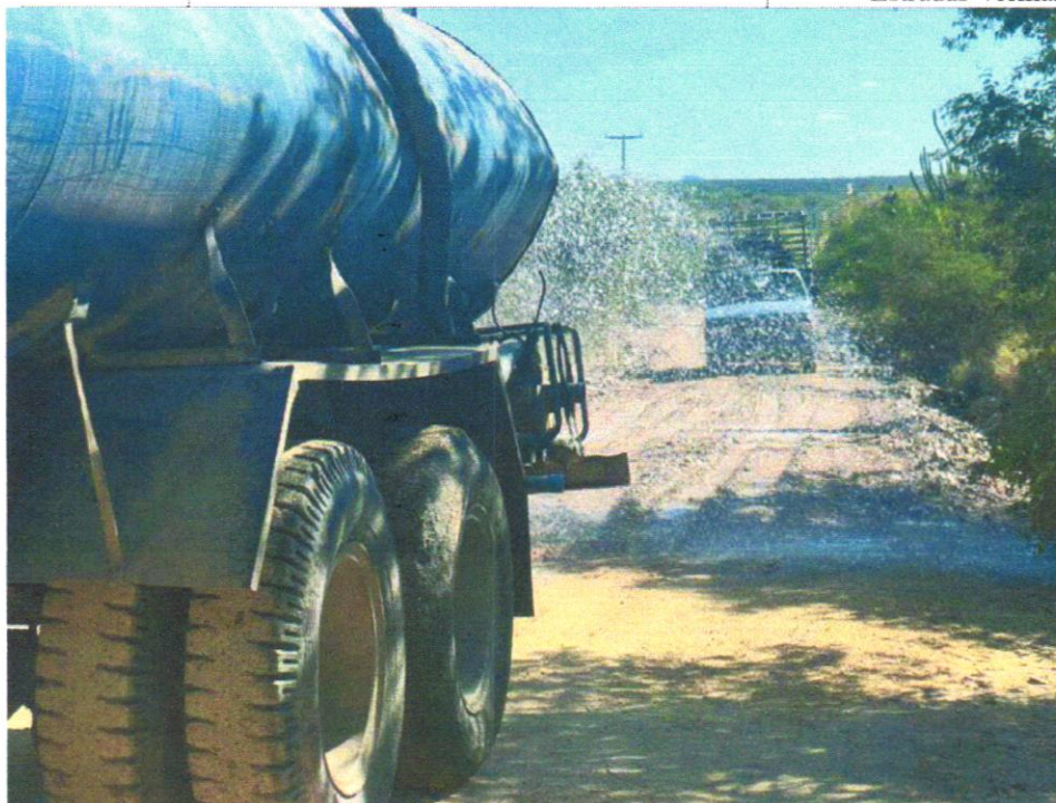
FOTO 03 - EXECUÇÃO E COMPACTAÇÃO DE ATERRO COM SOLO PREDOMINANTEMENTE ARGILOSO - EXCLUSIVE SOLO, ESCAVAÇÃO, CARGA E TRANSPORTE. AF_11/2019
